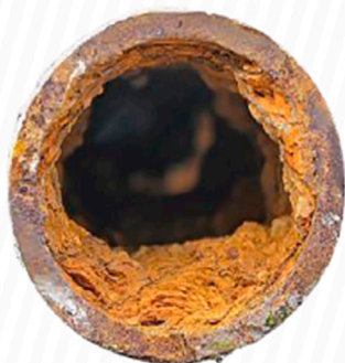
Рис. 2. Коррозионные повреждения трубопровода
