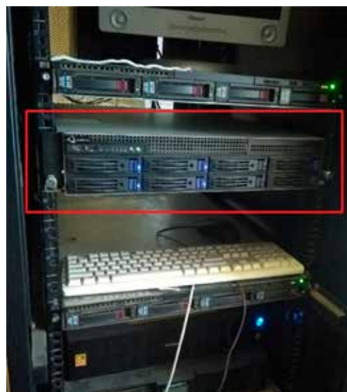
Рис. 1. Выбранный сервер на серверной площадке АФ ННГУ
