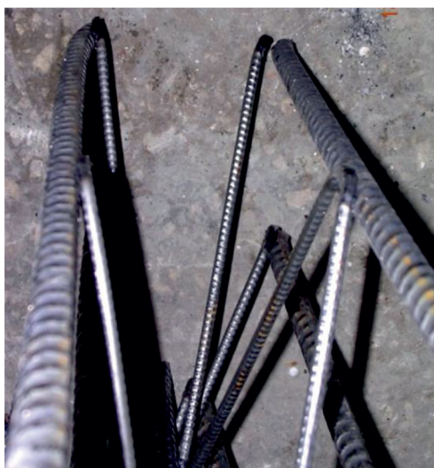
Рис. 5. Разрушение сварного соединения каркаса-тригона под нагрузкой
