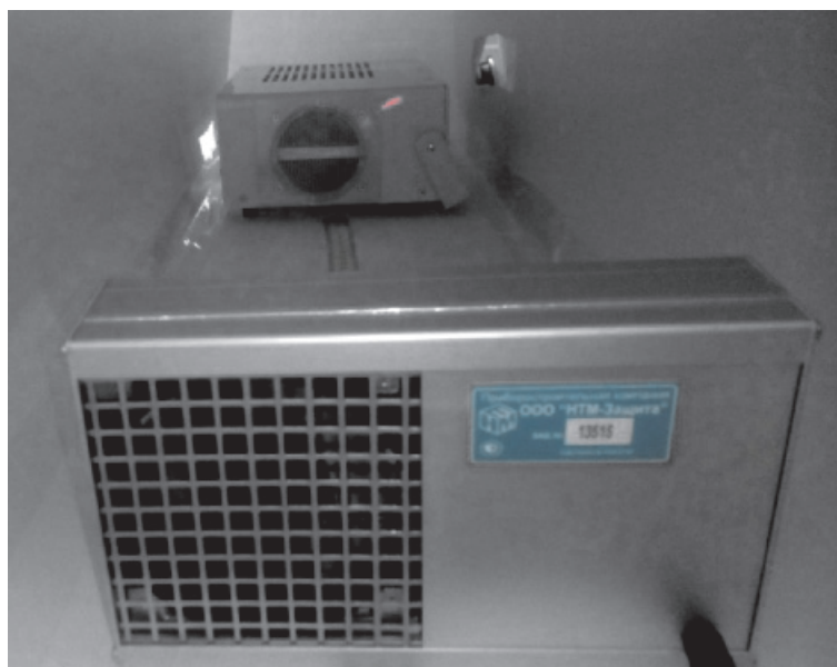
Счётчик и генератор аэроионов внутри воздуховода
