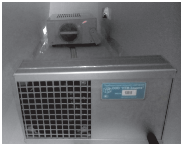
Счётчик и генератор аэроионов внутри воздуховода
